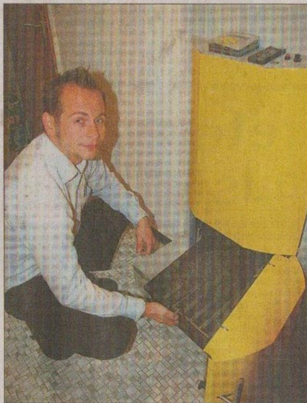
Er hat sein Eigenheim schon angepasst: Frank Hoopmann vor seiner neuen Holzpelletheizung. Foto: Nemitz
